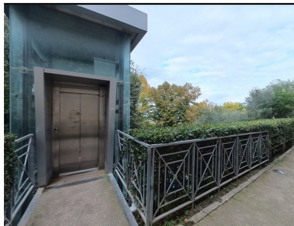
Ascensore del parcheeggio P3 Bagnaia Superiore
